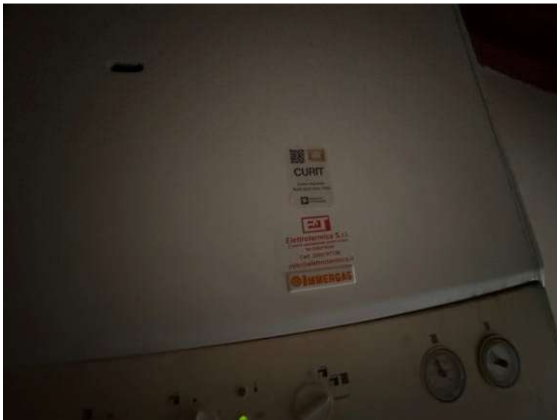
Caldaia Riscaldamento e ACS
